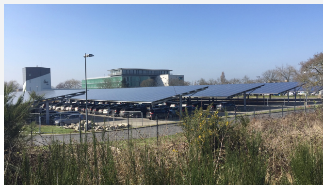
Crédit Agricole (Ploufragan - 22)- Ombrières de parking 981 kWc en injection sur le réseau électrique
